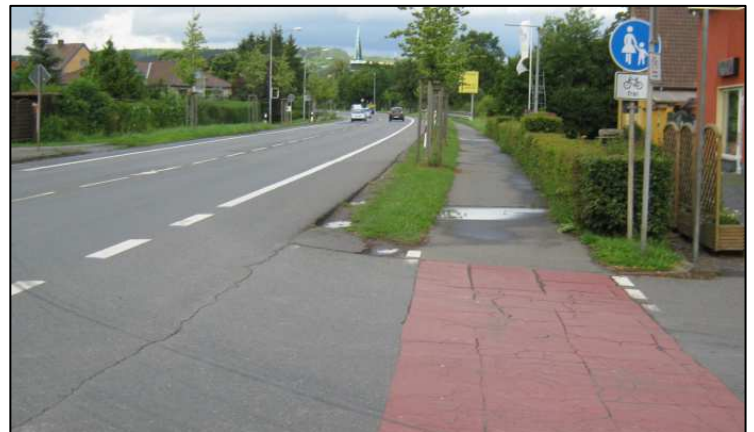
Bauliche Mängel im Zuge des Geh- und Radweges
